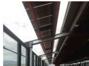
Vista dal basso dell'impianto fotovoltaico
